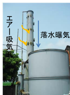
生物濾過池（側面）
