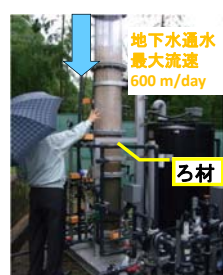
運転開始直後の生物ろ過塔
