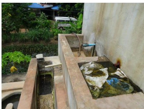
図 3 ゴミだらけの浄水場
