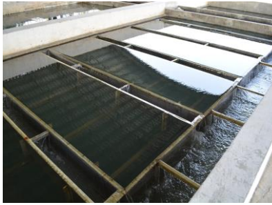
処理が良好な沈殿水の越流槽 マンダレーNo.4 浄水場
