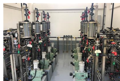
次亜塩素酸ソーダ注入装置 ニャンナピン浄水場
