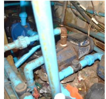
給水管と付随するブースターポンプの様子
