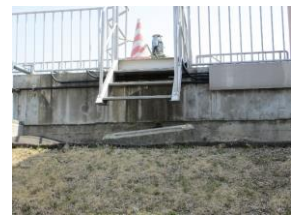
H24.4 蛇田浄水場、地盤沈下状況
