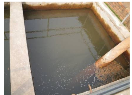
急速ろ過池もバイパスホースが
