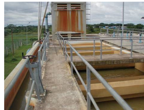
エアレーションとろ過による除鉄
