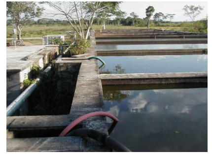
緩速ろ過池のバイパス
